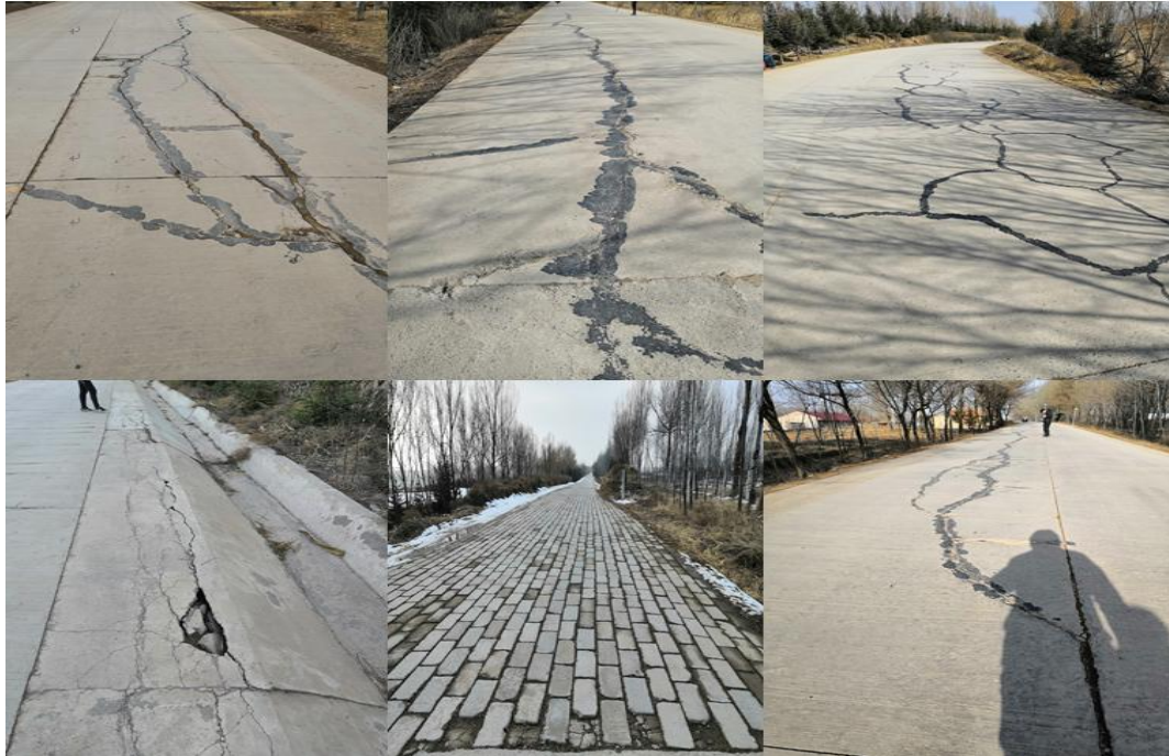
旧路路面病害以及沿线设施损毁概貌
